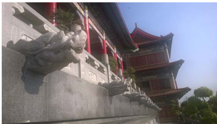
ภาพที่ 16 ท่อระบายน้ำรอบพระอุโบสถพระประธาน วัดบรมราชากาญจนภิเษกอนุสรณ์ นนทบุรี ที่มา นาย สุรศักดิ์ พลอยพิมพ์.วัดบรมราชากาญจนภิเษกอนุสรณ์. ถ่ายเมื่อวันที่ 2 กุมภาพันธ์ 2557
