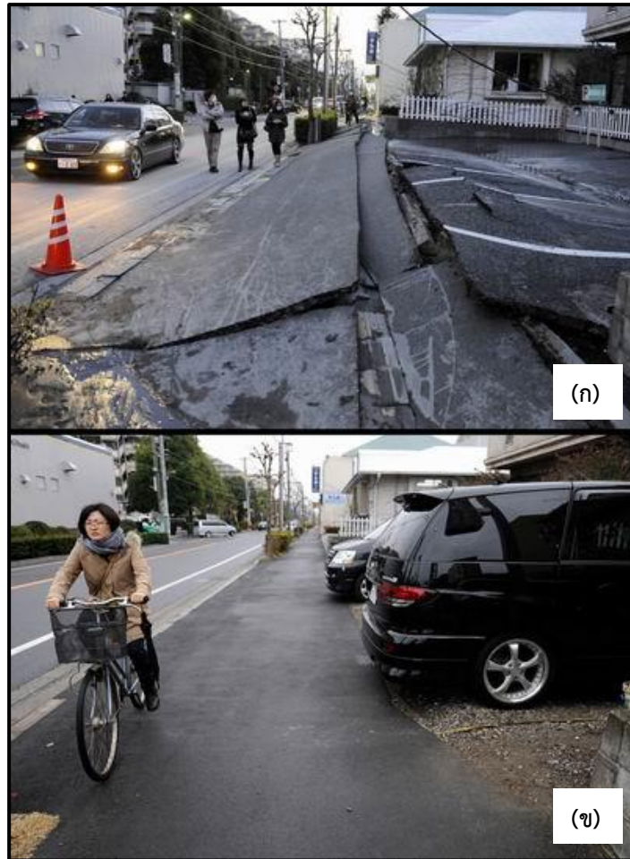
ภาพที่ 9 (ก) ทางเดินริมถนนที่เมืองอุระยาซึ จังหวัดชิบะ แตกร้าวเป็นทางยาวหลังเกิดแผ่นดินไหว บันทึกเมื่อ 11 มีนาคม 2011
